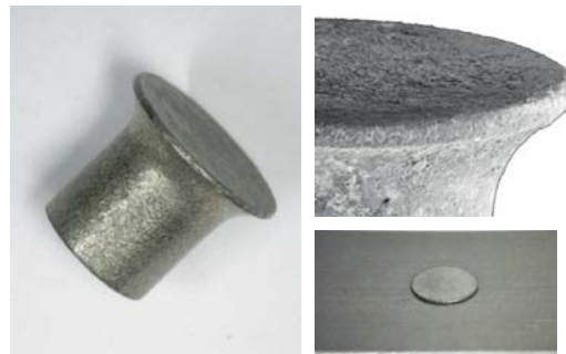
РИСУНОК 1. Слева: чистая заклепка. Вверху справа: заклепка с отложениями гидроксида магния (белый налет), образовавшимися вследствие коррозии. Внизу справа: крупный план заклепки в тестируемом листе.
