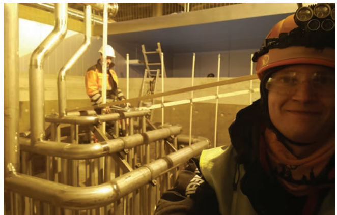
图 4 Eronen (前) 和 Ylönen 正在检查 Polar Night Energy 储热容器的管道系统。
