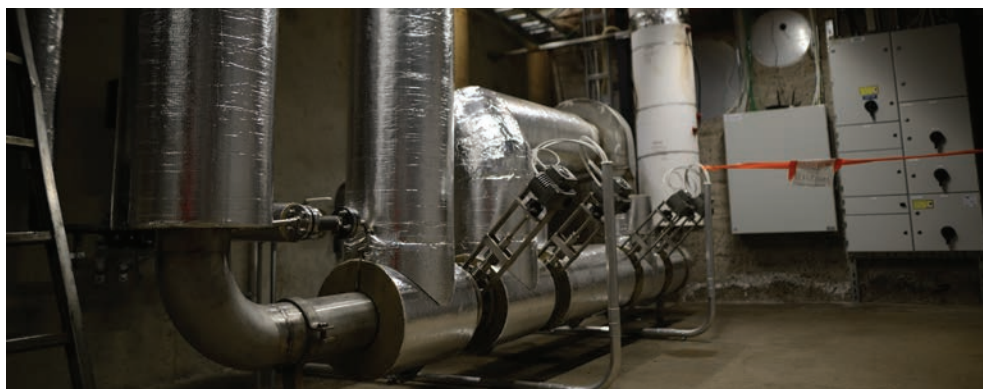
图 7 Polar Night Energy 公司在芬兰城市 Tampere 安装的传热系统的一部分。左边的垂直管道是热交换器的一部分，右边的电阻式加热元件包裹着白色绝缘材料。这些组件之间是空气循环径向鼓风机。
